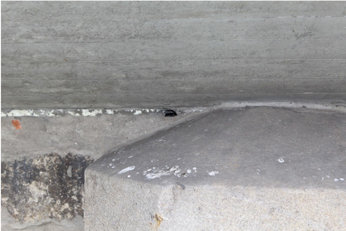
Abbildung 15: Spaltöffnung an der Brücke im verbauten Styropor
