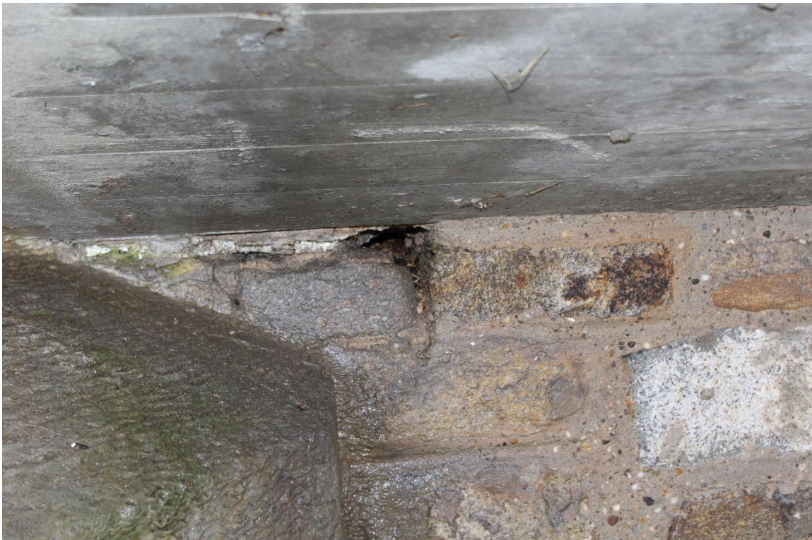
Abbildung 16: Spaltöffnung an der Brücke im verbauten Styropor
