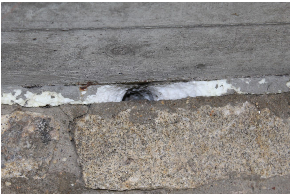
Abbildung 14: Spaltöffnung an der Brücke im verbauten Styropor
