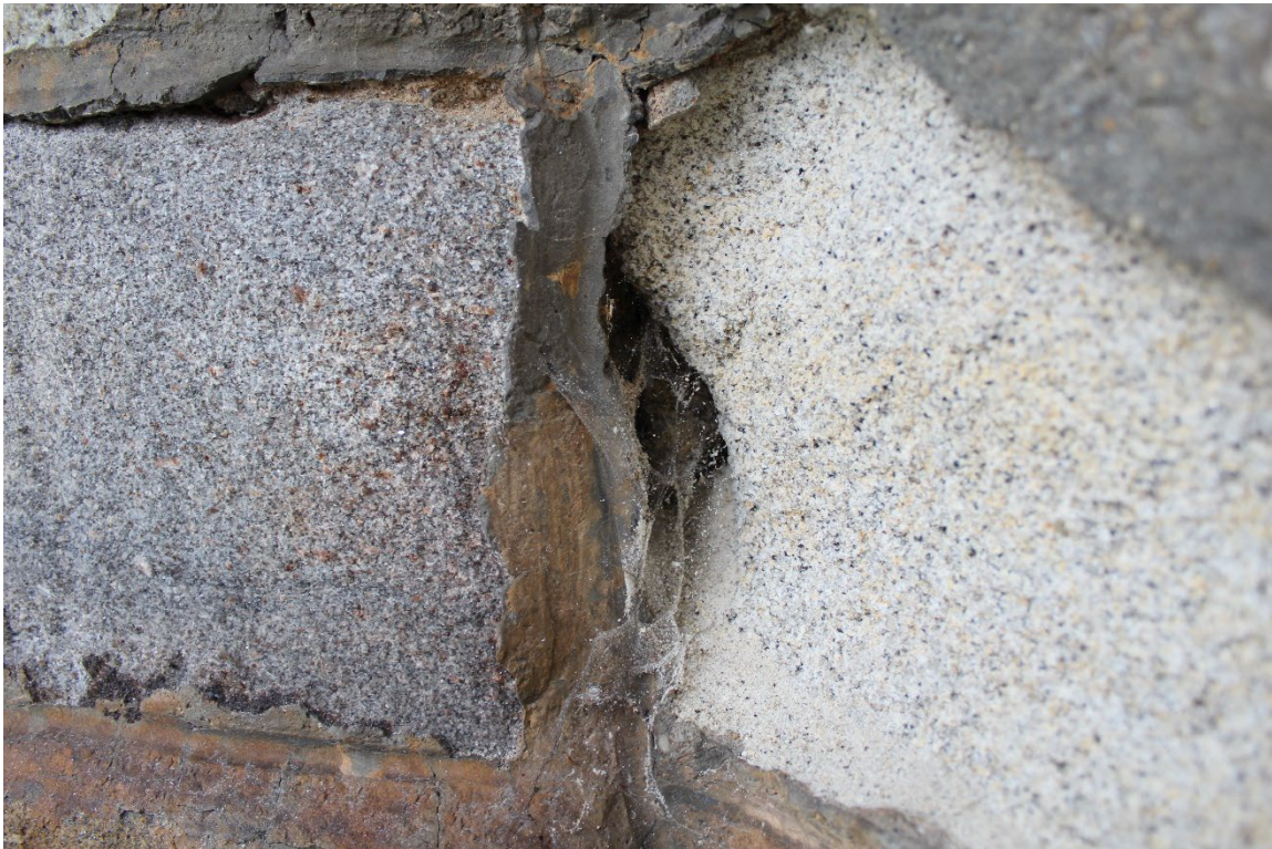
Abbildung 13: Spaltöffnung an der Brücke mit Spinnweben
